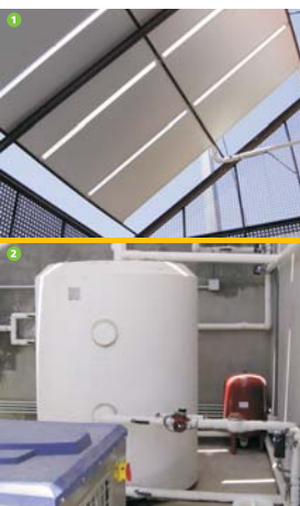
PLACAS SOLARES TÉRMICAS Tienen la función de recibir la radiación solar y transformarla en energía térmica en forma de agua caliente. En esta instalación disponemos de 10 colectores planos con una superficie total de 15,8 m 2 , capaces de alcanzar temperaturas cercanas a los 100°C, y producir al año unos 25200 kWh.
