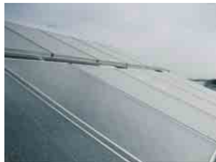
Colectores solares térmicos de placa plana, marca ROCA modelo PS2.
