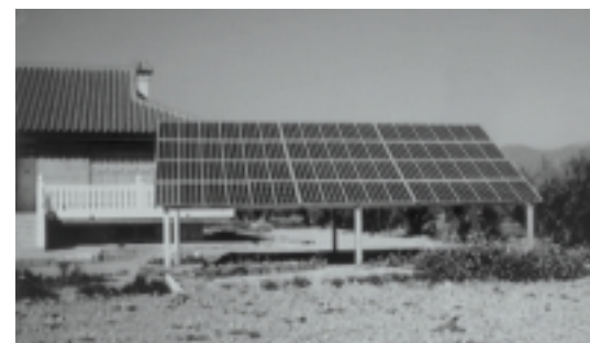
Instalación Solar Fotovoltaica aislada de vivienda rural. Lorca, Murcia.
