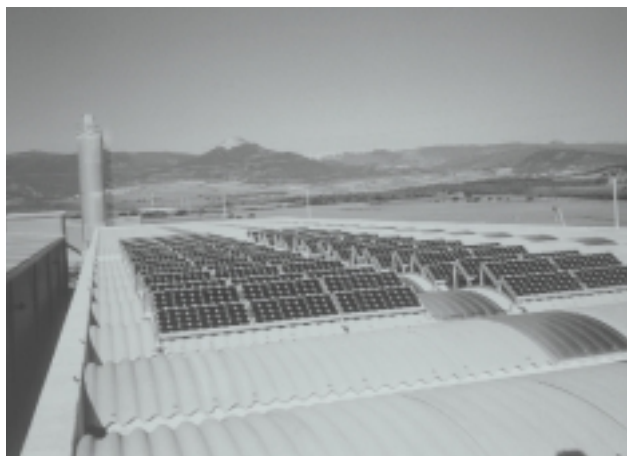
Conexión a red (AESOL) en cubierta de nave industrial. Navarra.
