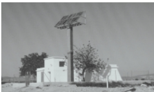
Instalación Solar Fotovoltaica en estación de telecontrol e iluminación. Los Martínez del Puerto. Murcia.
