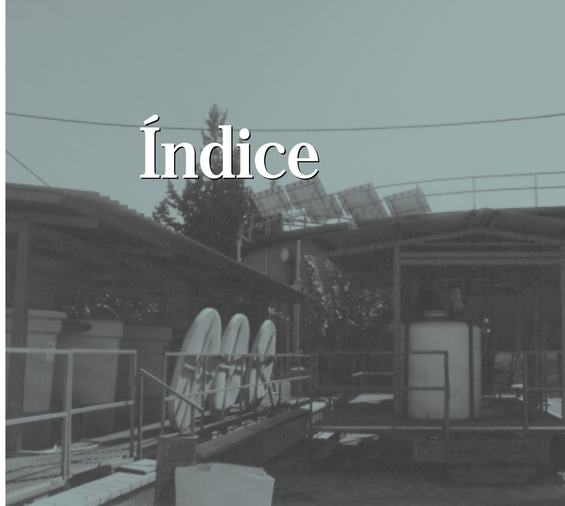
Instalación Solar Fotovoltaica en Zarandona. Murcia
